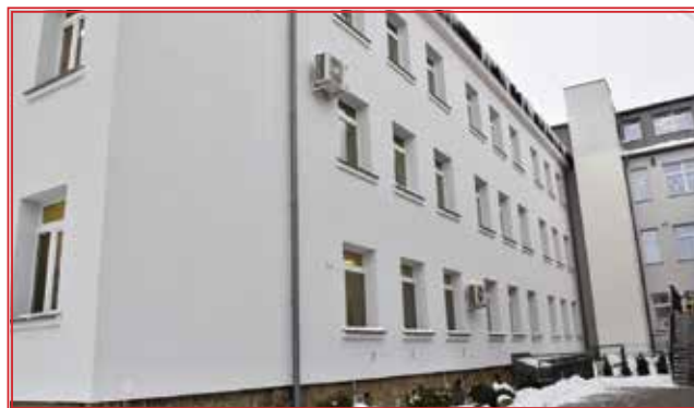
Wybudowano szyb windy dla dźwigu osobowego, wymieniono na nową stolarkę okienną, ocieplono ściany
